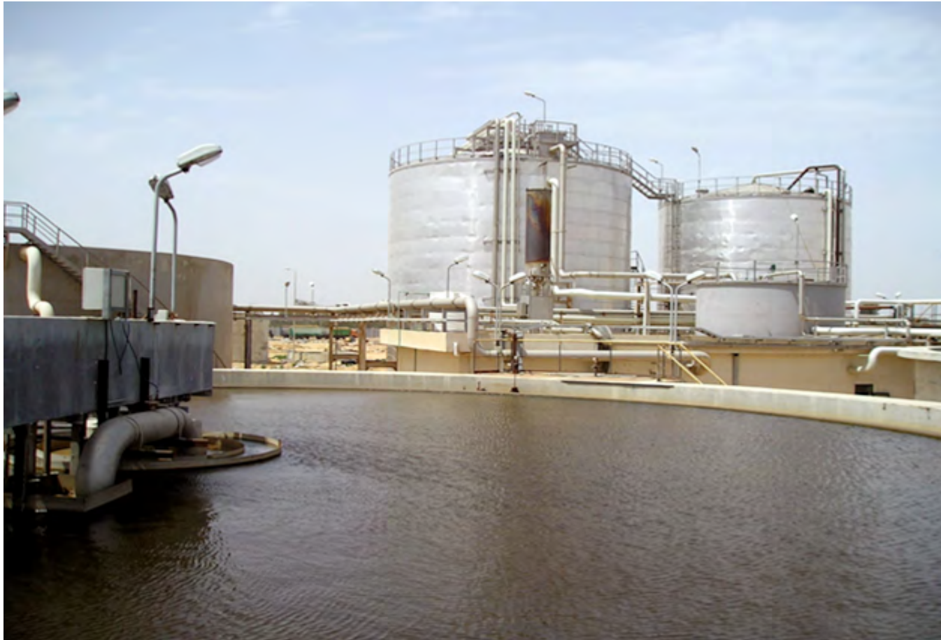
Anaerob-aerobe Abwasserreinigungsanlage in einer ägyptischen Zuckerrübenfabrik.
