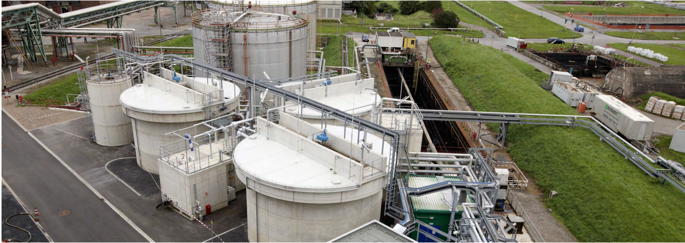
Zulaufsammler mit Rechen- und Pumpwerk und der ersten Entölungsstufe, bestehend aus drei parallelen Öl-Separatoren.
