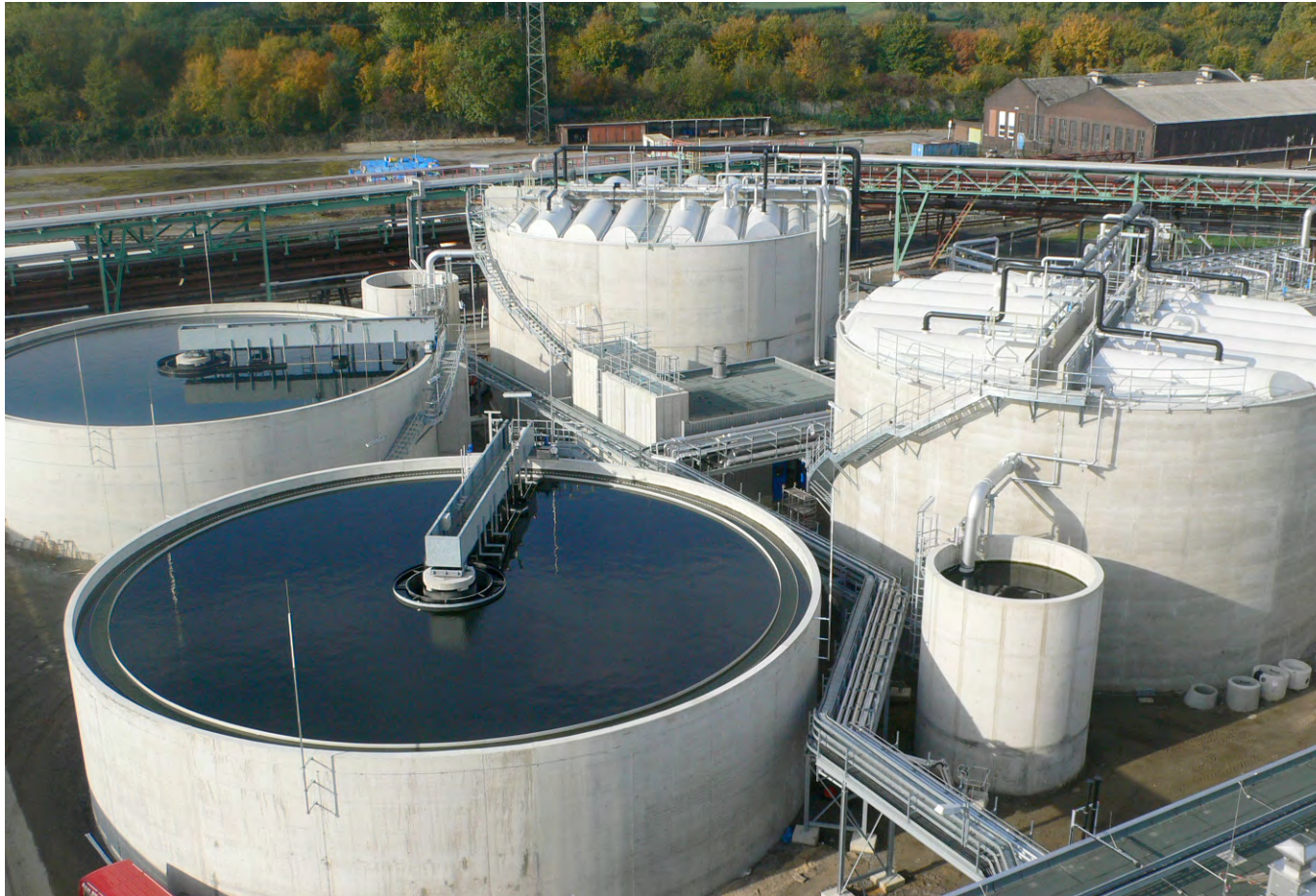
Abwasser- und Abluftbehandlung von HAGER + ELSÄSSER in der Raffinerie der Ruhr Oel GmbH in Gelsenkirchen-Horst.
